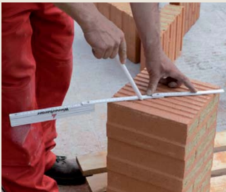
7.8.5 Řezy se naznačují jak pro pilu pro mokré řezání, tak i pro ruční pilu.
